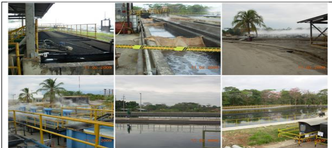
Fotografía 8. Unidades que conforman el sistema de tratamiento de aguas residuales industriales en la Estación Castilla 2.
