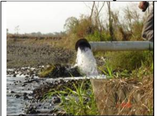
Foto 4. Vertimiento del agua tratada al Río Guayuriba
