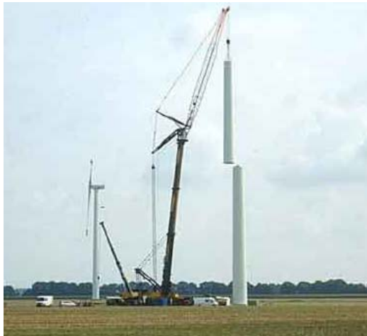
Levantamiento de las partes de la torre de un aerogenerador. Fuente: http://nordex-online.com .
