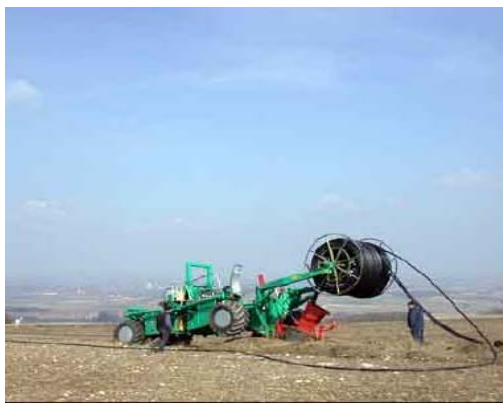
Cableado interno parque eólico. Fuente: http://nordex-online.com .
