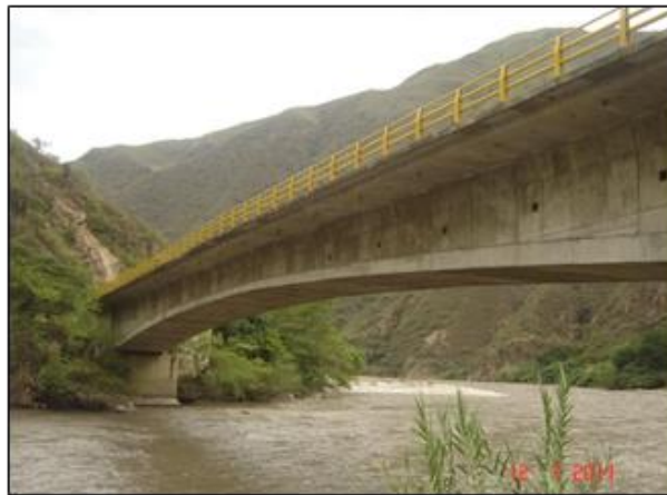
Ilustración 11: Estado del Puente Pescadero durante la visita llevada a cabo el 12 de julio de 2011. (Cusba Morales, 2011)
