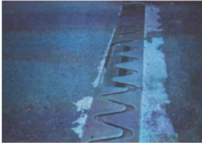
Ilustración 10: Estado de la juntas de dilatación durante la inspección al Puente Pescadero en junio de 1995. Fuente: (SAC Estructuras Metálicas, 1995). (Cusba Morales, 2011)
