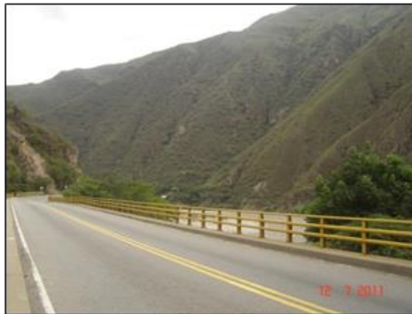
Ilustración 12: Estado de la superficie de rodadura del Puente Pescadero. (Cusba Morales, 2011)
