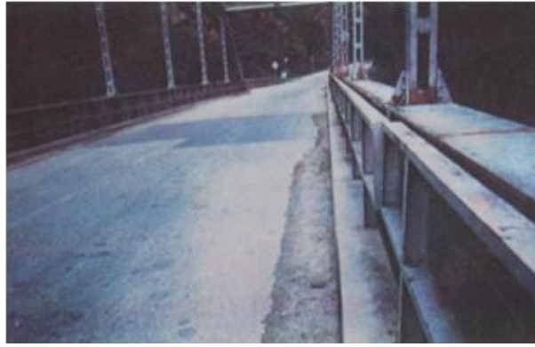
Ilustración 9: Baranda caída a causa del desbancamiento de la placa durante la inspección al Puente Pescadero en junio de 1995. Fuente: (SAC Estructuras Metálicas, 1995). (Cusba Morales, 2011)
