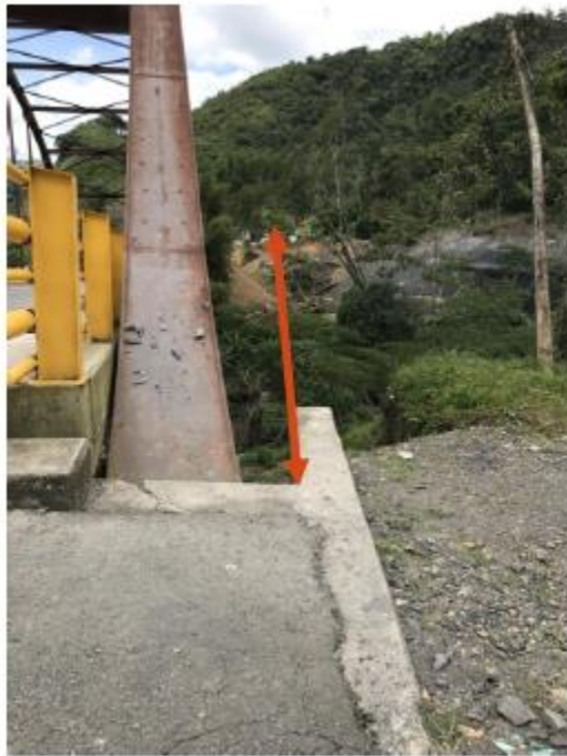
Ilustración 52: Costado Puerto Boyacá - aguas arriba, se puede hacer la proyección del único estribo que quedo en su lugar y se ve todo lo que se desplazó el puente
