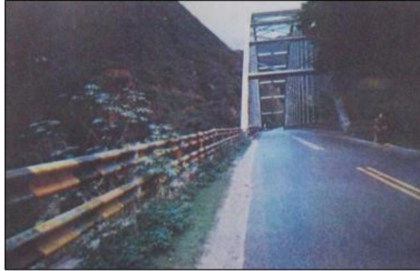
Ilustración 5: Vista lateral de la Inspección al Puente Pescadero localizado sobre el Río Chicamocha en junio de 1995. Fuente: (SAC Estructuras Metálicas, 1995). (Cusba Morales, 2011)
