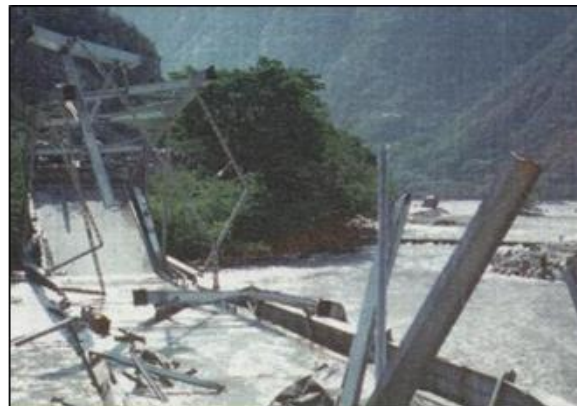
Ilustración 15: Puente Pescadero colapsado el 7 de enero de 1996. (Notivías, Puente Pescadero colapsado, 1996).
