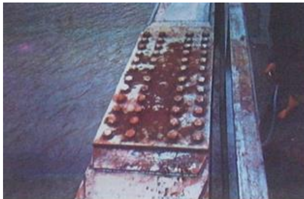
Ilustración 7: Cubre juntas oxidado durante la inspección al Puente Pescadero en junio de 1995. Fuente: (SAC Estructuras Metálicas, 1995). (Cusba Morales, 2011)
