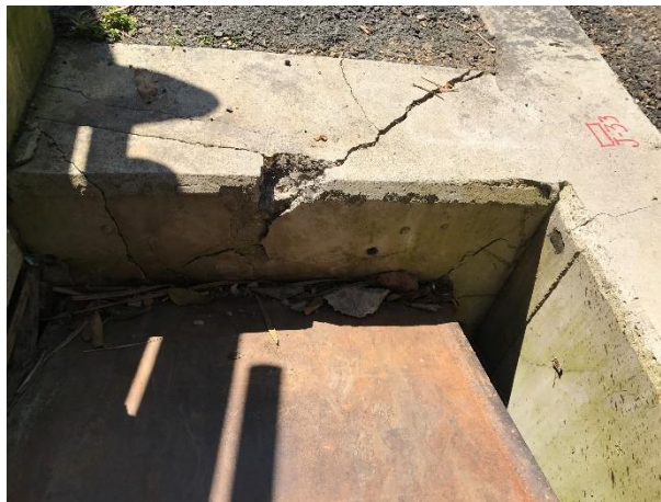
Ilustración 24: Grietas por inclusión de arco en estribo.
