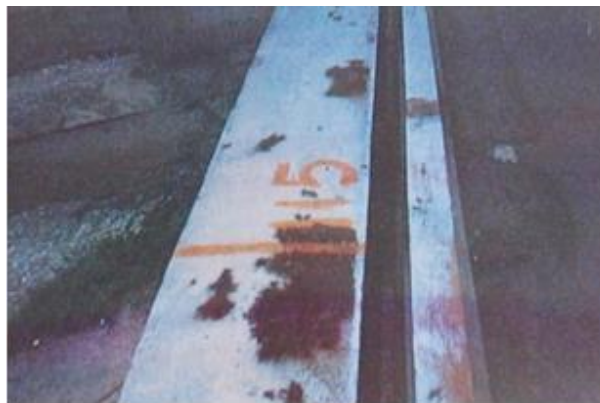
Ilustración 6: Viga de rigidez oxidada durante la inspección al Puente Pescadero en junio de 1995. Fuente: (SAC Estructuras Metálicas, 1995). (Cusba Morales, 2011)
