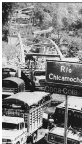
Ilustración 22: Puente Pescadero luego de su colapso ocurrido el 7 de enero de 1996. Fuente: (Tiempo, 1996). (Cusba Morales, 2011)
