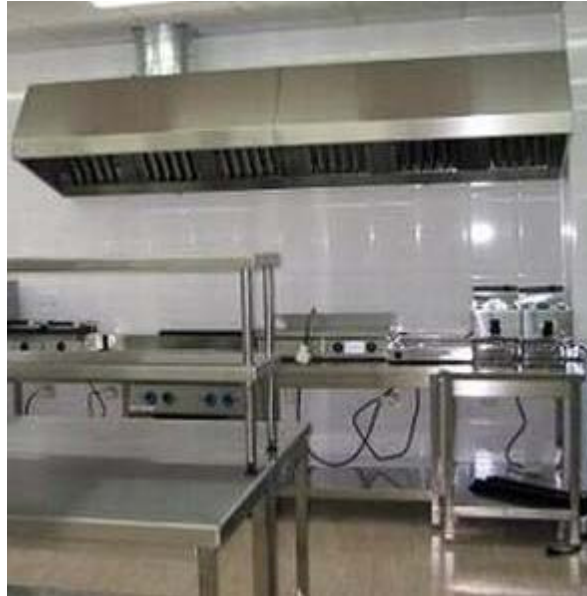
Figura 56. Ventilación y sistema de extracción.
