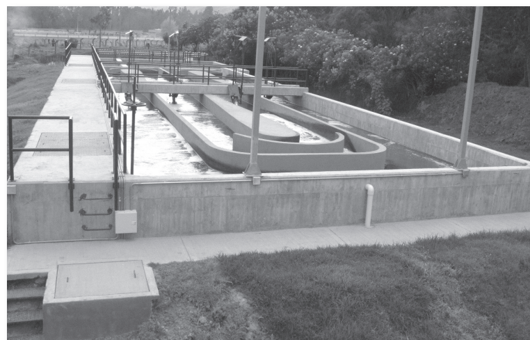
Esta moderna planta de tratamiento descontamina las aguas residuales provenientes de la Clínica y del Inalde.
