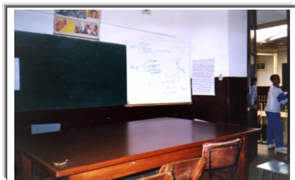
FOTO 2. MUEBLES. Las instalaciones de la biblioteca no cuenta con el inmobiliario adecuado, Para este tipo de servicio, dado su gran tamaño, rigidez y mala presentación por la falta de mantenimiento.
