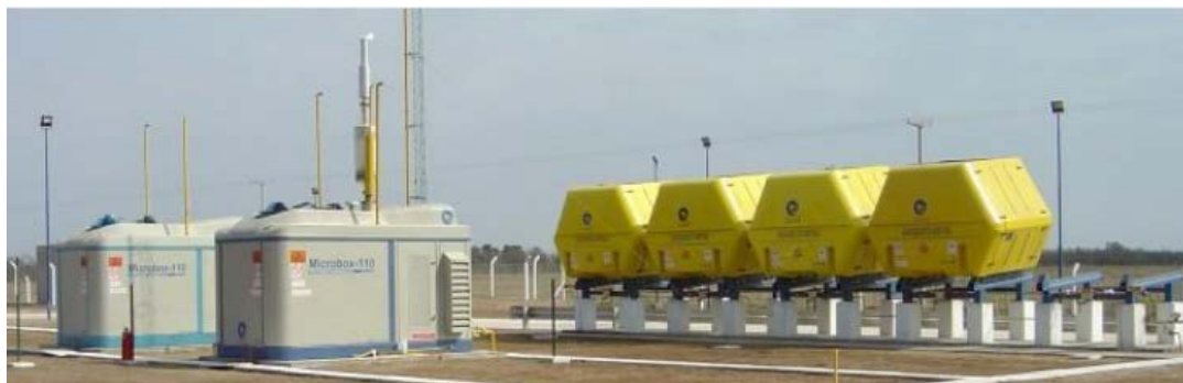
Figura 5. Estación de Compresión y Carga – General Levalle, Cordoba, Argentina. Fuente: Surpetroil S.A.S.
