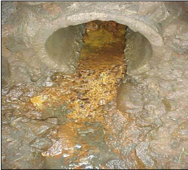
Registro fotográfico 2: Detalle del daño causado al alcantarillado municipal
