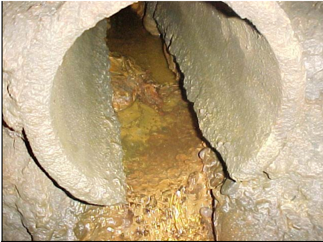
Registro fotográfico 1: Detalle del daño causado al alcantarillado municipal
