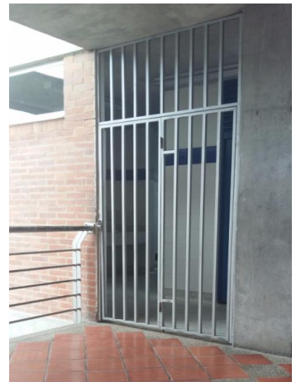
Imagen 14: Los baños de la sede tuvieron que ser cerrados y solo los del primer piso están siempre abiertos.
