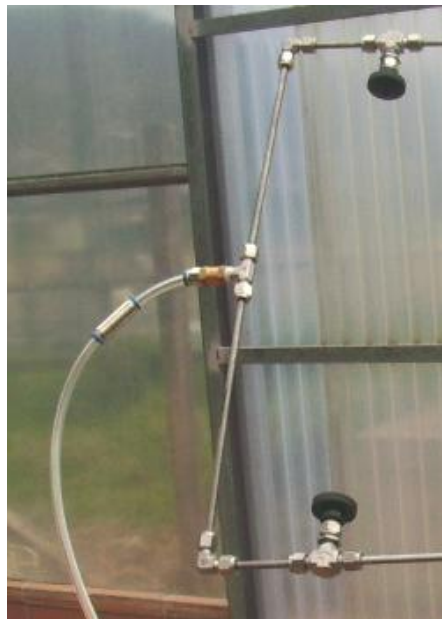
Figura 55: Manguera neumática de alimentación de CO 2 , conectada con unión “Te” de tubería metálica. Autor 2009.
