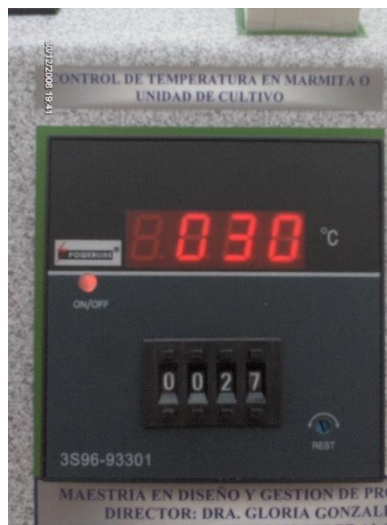
Figura 48: Dispositivo de control de temperatura en la marmita. Autor 2009.
