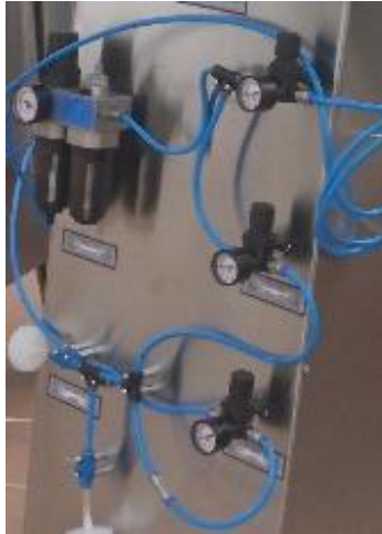
Figura 50: Control de porcentaje de CO 2 mezclado con aire suministrado en el serpentín. Autor 2009.
