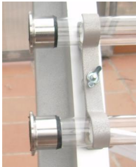
Figura 41: Abrazaderas dobles para fijación de tubería a soporte. Autor 2009
