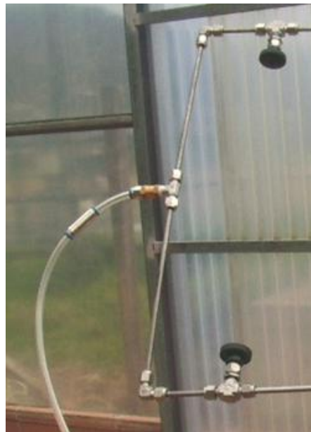
Figura 5. Manguera neumática de alimentación de CO 2 conectada con Te de unión de tubería metálica
