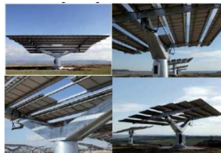
Figura 84. Imágenes seguidores solares ADES15
