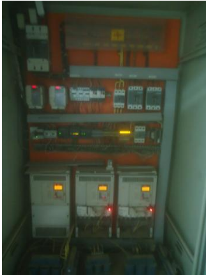
Variadores de frecuencia, que bajan el consumo de energía.
