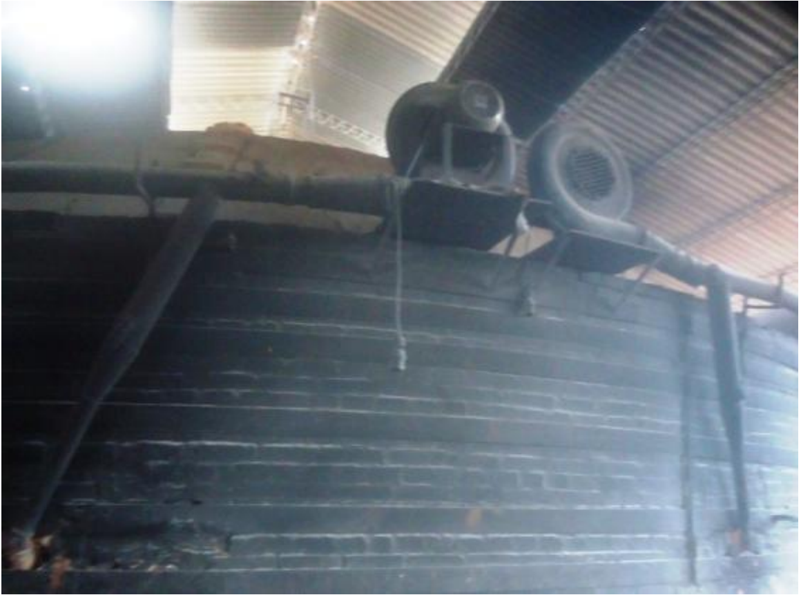
Sistema de dosificación de aire controlado con turbinas para la combustión.
