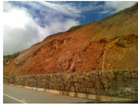
T.C. 2 (Talud control No. 2) Ubicación: Km 4 Vía Duitama – Tunja (Trinidad Vereda Higueras)
