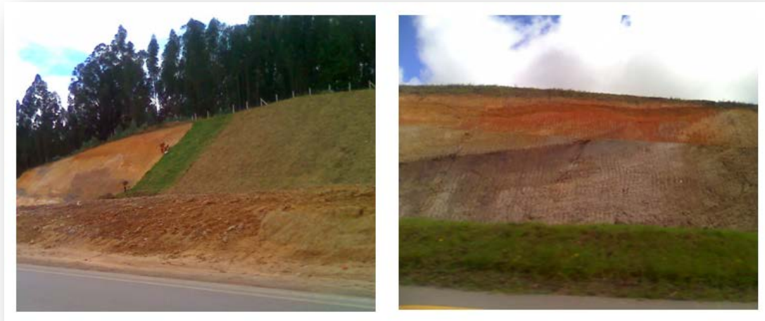
Figura 2. Desmontes Fuente: Autor.
