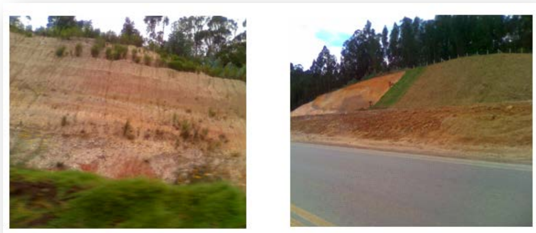
Figura 14. Desmontes en el área de estudio Fuente: Autor
