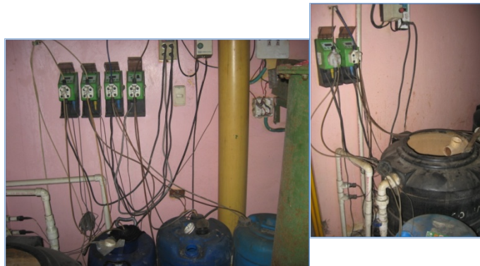
Figura 9. Controladores de pH y REDOX - bombas dosificadoras
