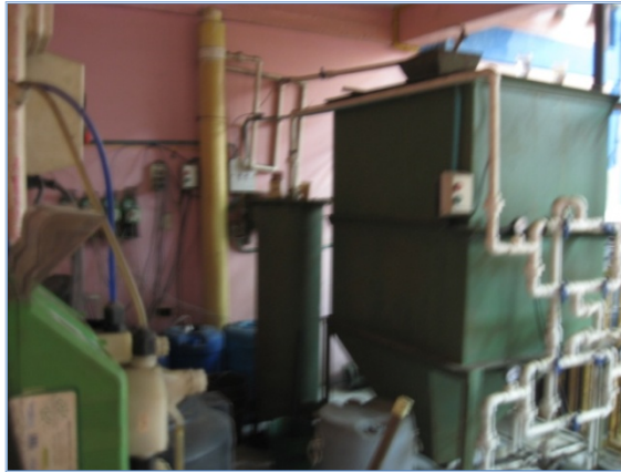
Figura 10. Reactor y filtro de arena
